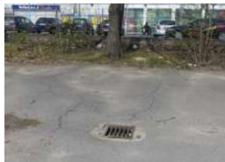
Risse im Asphalt
