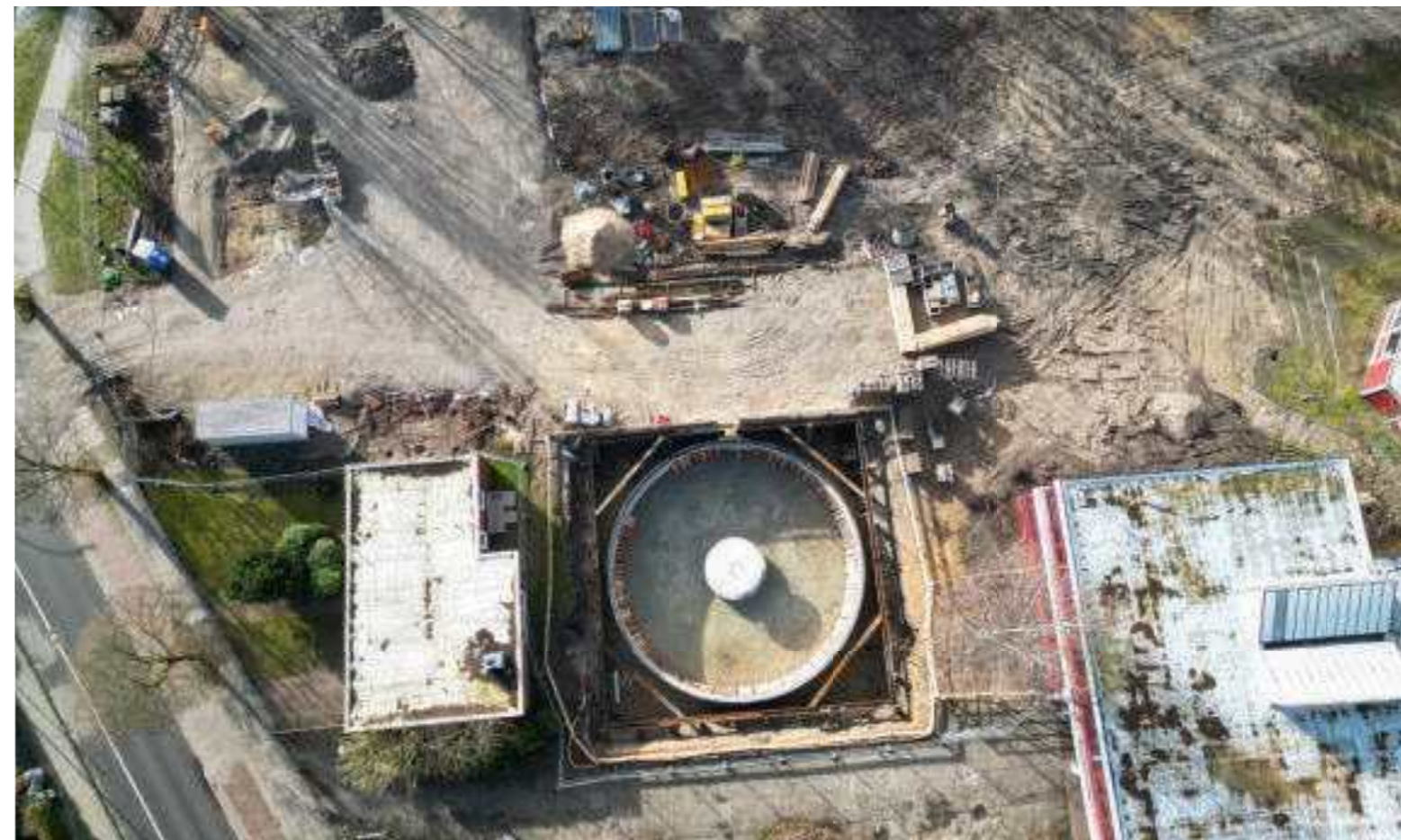
Fortschrittliche Technologie: Bei dem Erweiterungsbau am Schulzentrum Nord sorgt eine Eisspeicherheizung künftig für Energie im Schulalltag.
