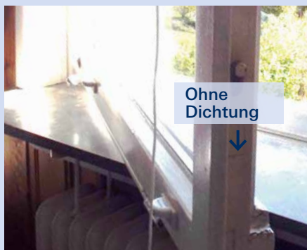
Bild 2/3: Fenster mit Isolierglas, ohne Dichtung (typisches Merkmal Hebelfunktion mit Gestänge)
